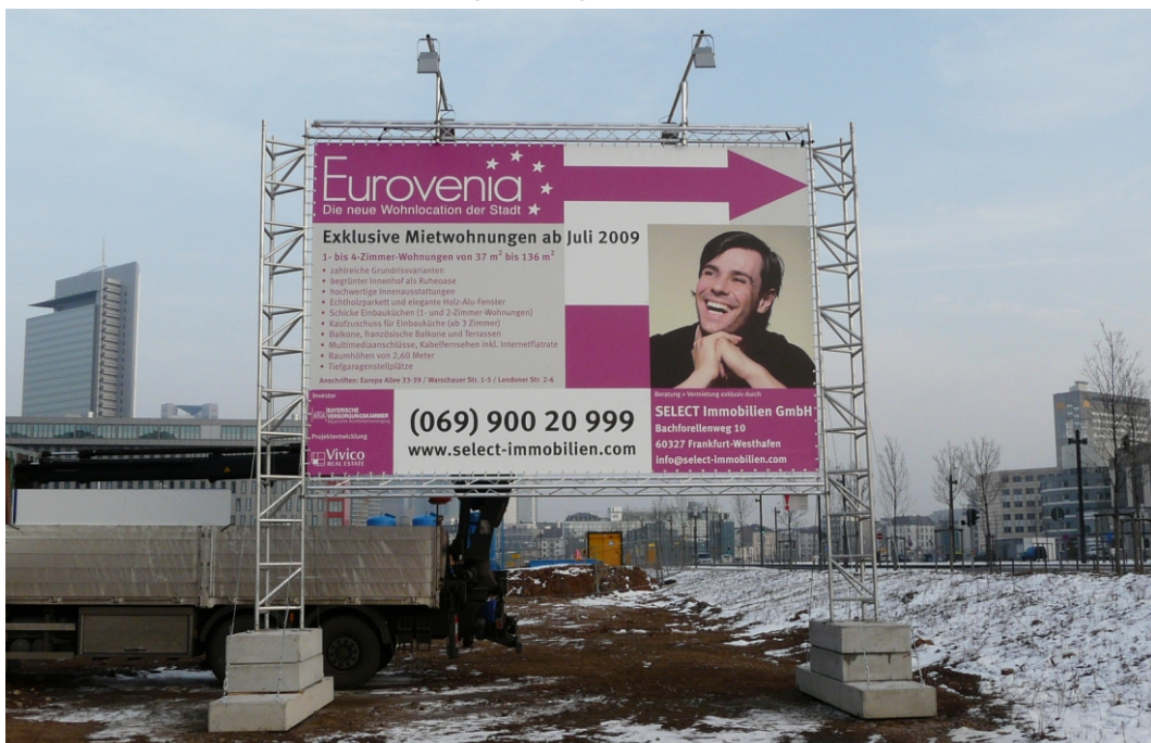
Alu-Gitterträger-Unterkonstruktion, weit gespannt, mit Blockout-Plane und Beleuchtungsanlage mit zwei HQL-Strahlern
