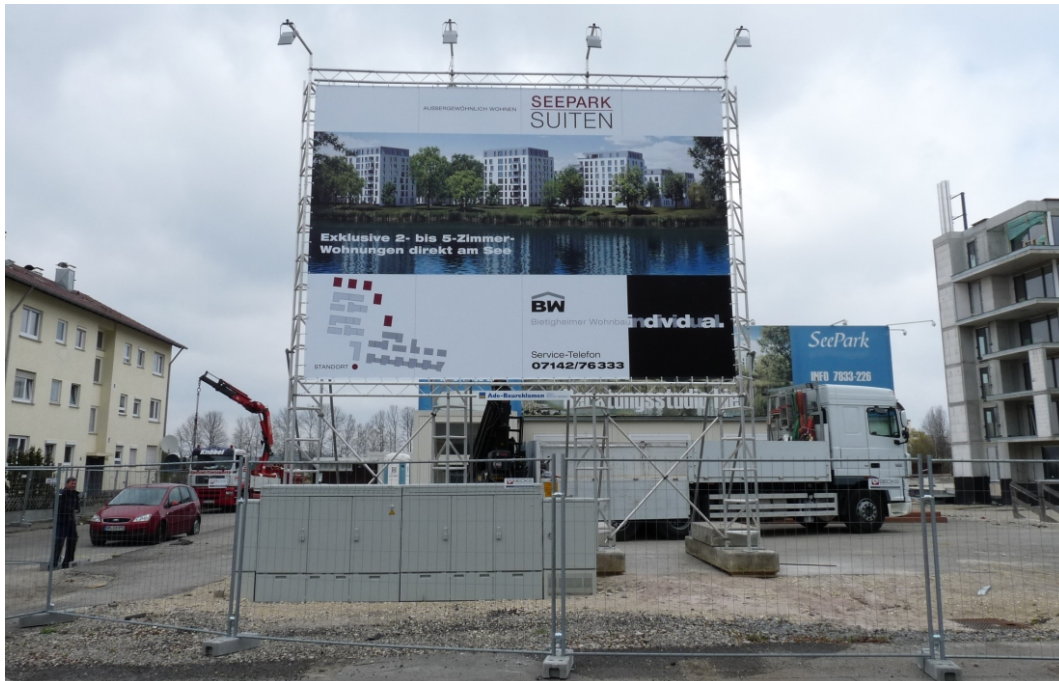
Alu-Gitterträger-Unterkonstruktion mit 700 x 500 cm großer Blockout-Plane und Beleuchtungsanlage mit vier HQL-Strahlern
